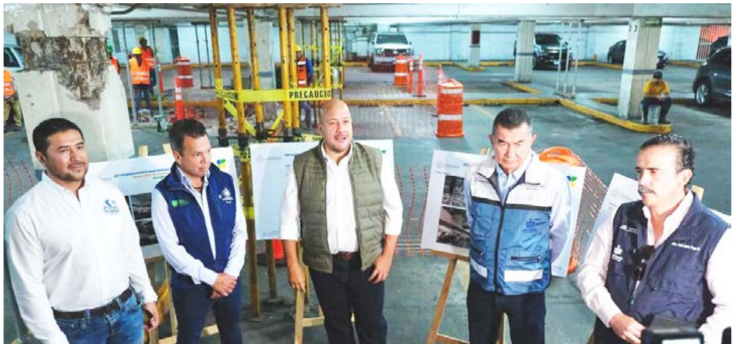
Es un estacionamiento que todos los tapatíos conocemos y que ya es evidente el paso del tiempo. Esta realidad es lo que hace necesario que cada vez que haya un evento arriba en la Plaza Liberación se tengan que reforzar los puntales del estacionamiento y tomamos la decisión junto con el Gobierno de Guadalajara, de que vamos a arrancar ya una intervención integral”, destacó el mandatario, Enrique Alfaro.
